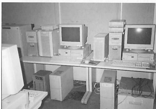
CDR及びサーバー装置
